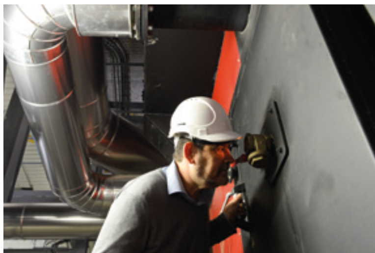
La chaufferie bois de Bellevue
