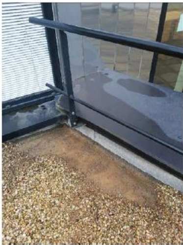
RELEVE CLOQUE A REPENDRE EN FLASHING
