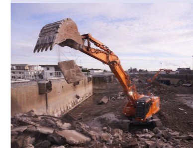
Deuxième phase de démolition avant mise en place des derniers ouvrages (source : reportage photo Double Mixte)
